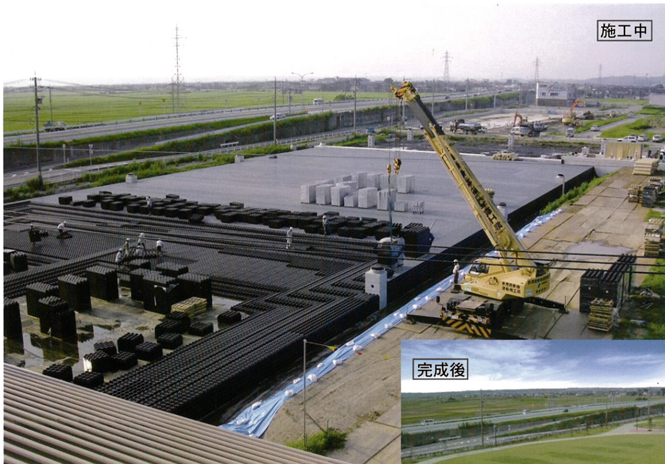
石川縣內整理池(儲水量:9,200m 3 )
