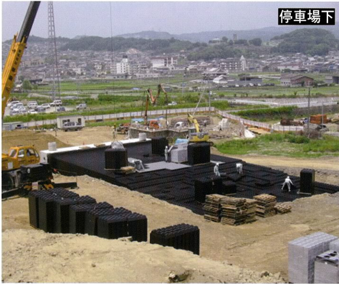
奈良縣調整池(儲水量:720 m 3 )
