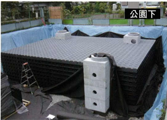
東京都內雨水利用儲水池(儲水量:100m 3 )
