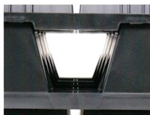
雨水收集內部
