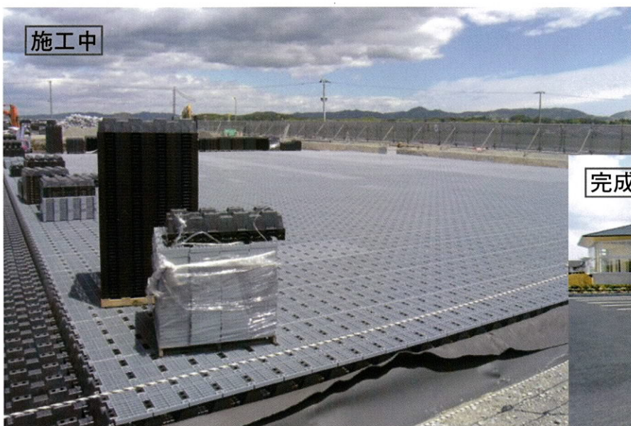
宮城縣政府調整池(儲水量:1,700 m 3 )
