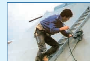
鬆鋪固定法的PVC防水膜焊接，即使在大斜坡或懸吊式的屋面上均可輕鬆解決焊接問題。
