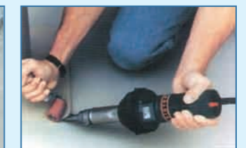
手提焊槍搭配20mm寬焊嘴和壓力輓用於手工焊接小面積的屋面PVC防水膜。
